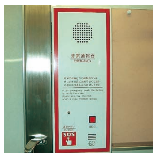
車内非常通報装置
