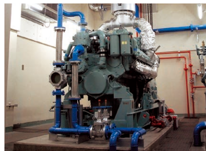
非常用発電機
