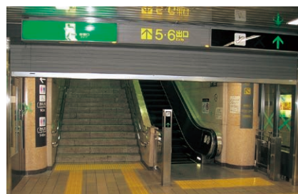
防火防煙シャッター
